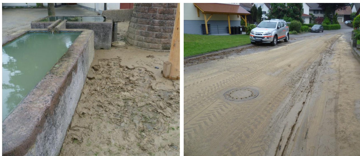
Abb. 60: Schäden durch Schlamm in Schallbach (Fotos: Büro Moser)
